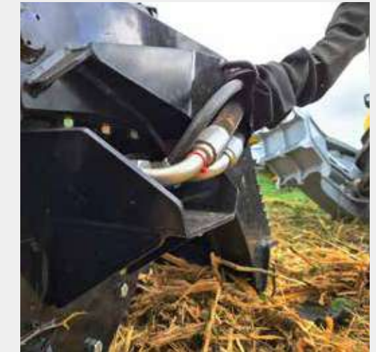
Protection des tuyaux
